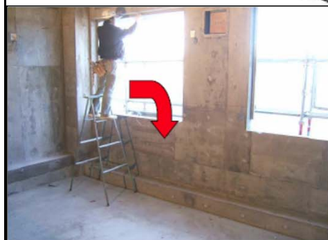
当社の災害事例 20-19-「墜落・転落」
