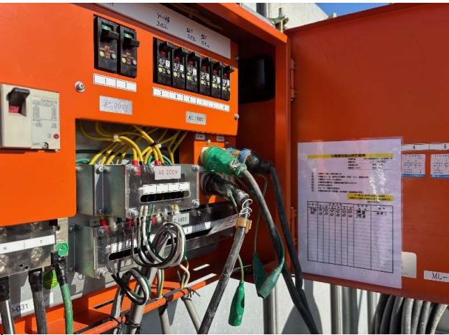
分電盤設置状況
