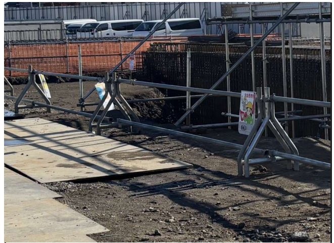
安全音声標識設置状況
