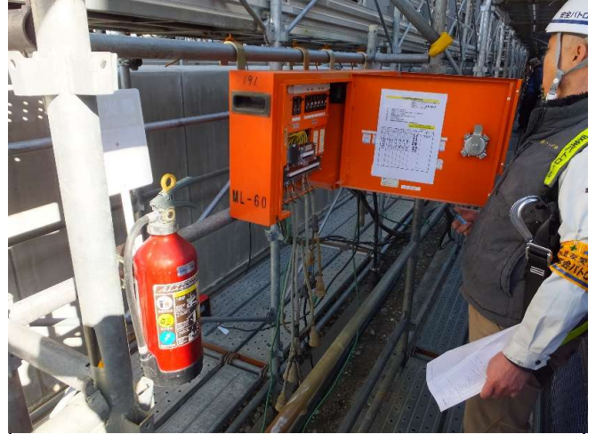
分電盤設置状況
